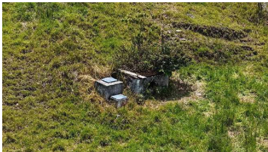
Imagen 55. Foto del Tanque de captación 3.
