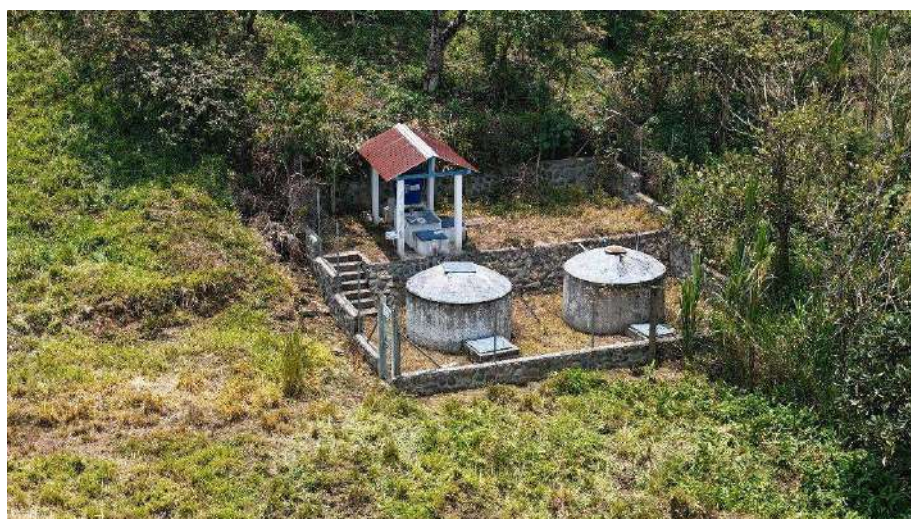
Imagen 56. Foto de la planta de tratamiento agua potable.
