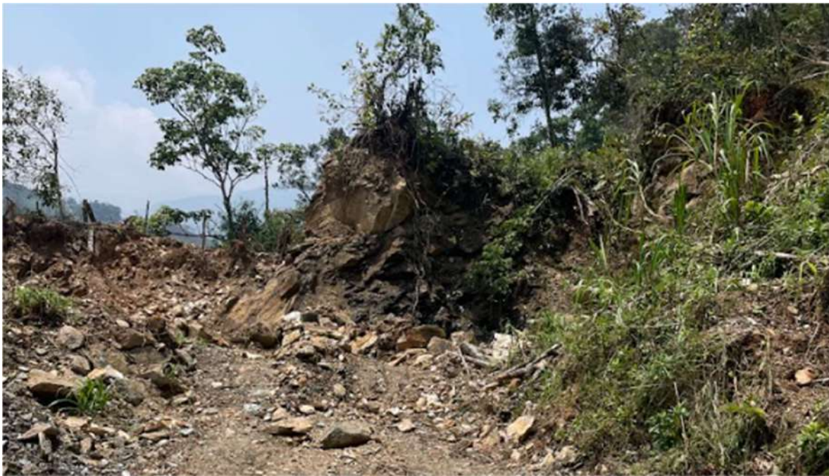
Descripción: Deslizamiento por movimientos de masas en senderos del poblado Flor del Bosque. Fuente: Levantamiento en campo, 2024.
